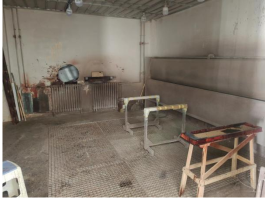
底漆房水帘柜
