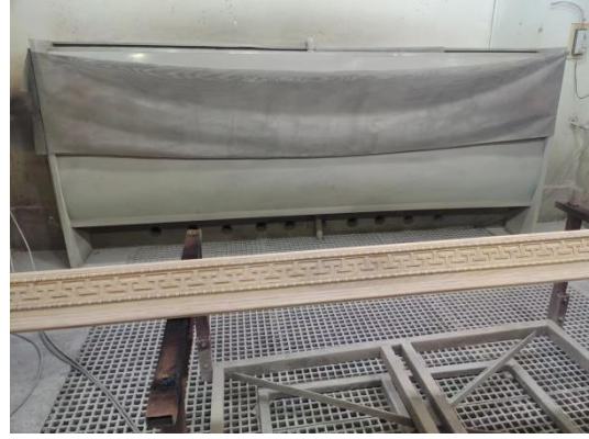
面漆房水帘柜
