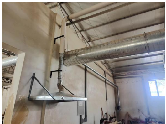
施胶车间废气收集装置
